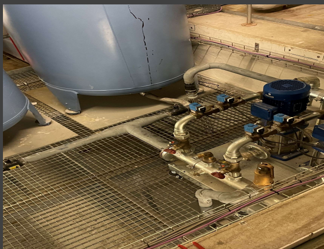
Støj fra centralen i Nord, trykholder anlæg er bygget om
