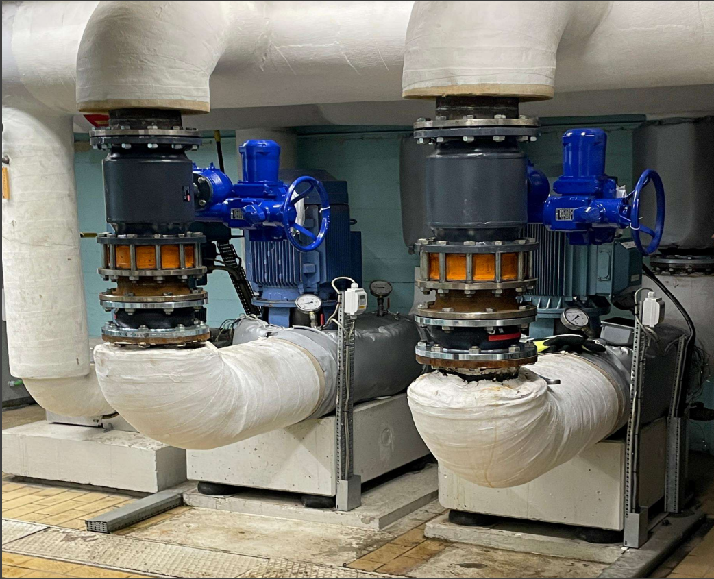
Slidte ventiler udskiftes i Midt
