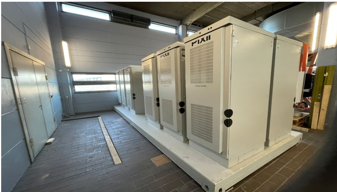
Batteribanken er opsat i centralen ift. datacenteret
