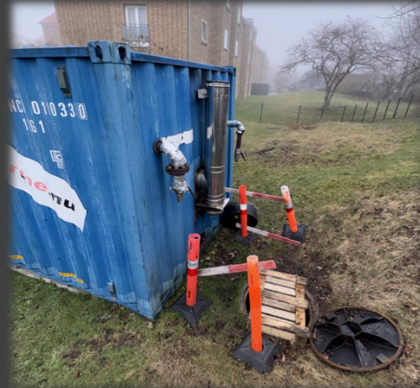
Olietank og oliekedel ved Spurvegården
